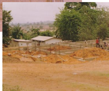
De fundering voor vier appartementen voor artsen ligt er al. Ook deze bouw gaat voorspoedig (rechts)
